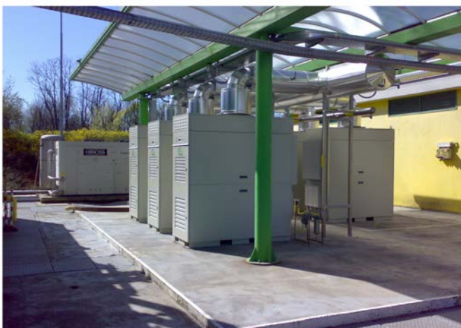
Impianto di trigenerazione
